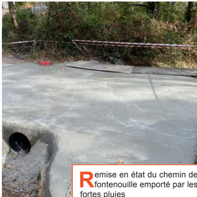
R eprise de la voirie au gué du chemin des granges, permettant le raccordement en douceur avec le lit de la Camiole.
