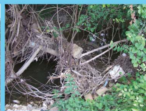
Manque d'entretien, gênant le libre écoulement des eaux
