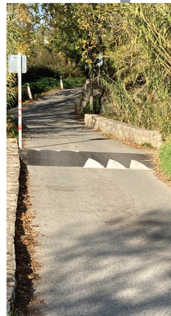
Ralentisseur et reprise du pluvial au chemins Crottons.
